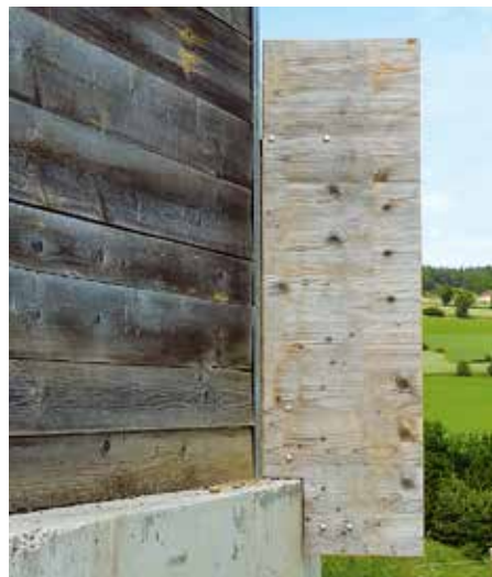
Schutz gegen Zugang zu ungesicherter Mauerkrone
