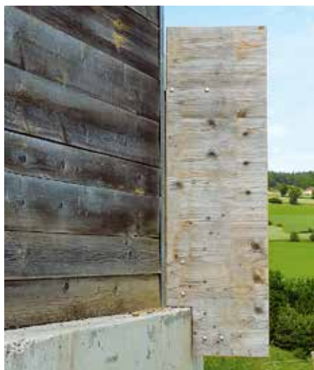
Schutz gegen Zugang zu ungesicherter Mauerkrone
